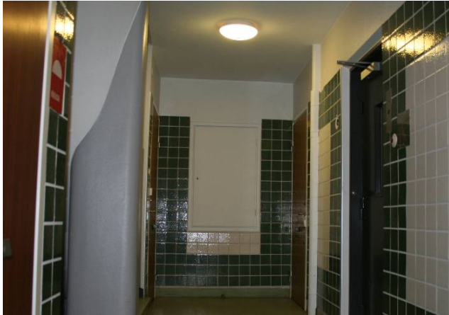
Närvarostyrda lågenergiarmaturer har installerats i bland annat trapphus.
