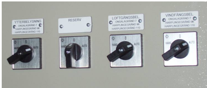
Apparatskåp för styrning av ytterbelysning, loftgångsbelysning och belysning i vindfång. I läge ”Auto” styrs belysningen av inställd tidkanal.
